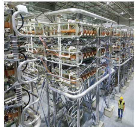
Konverterhalle einer Stromrichterstation der HGÜ-Verbindung zwischen Frankreich und Spanien.
