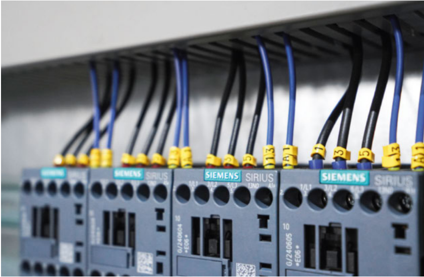
Die Siemens-Komponenten in den Carbon Cleanup Units sorgen für die Umsetzung des patentierten Aufbereitungsverfahrens.
