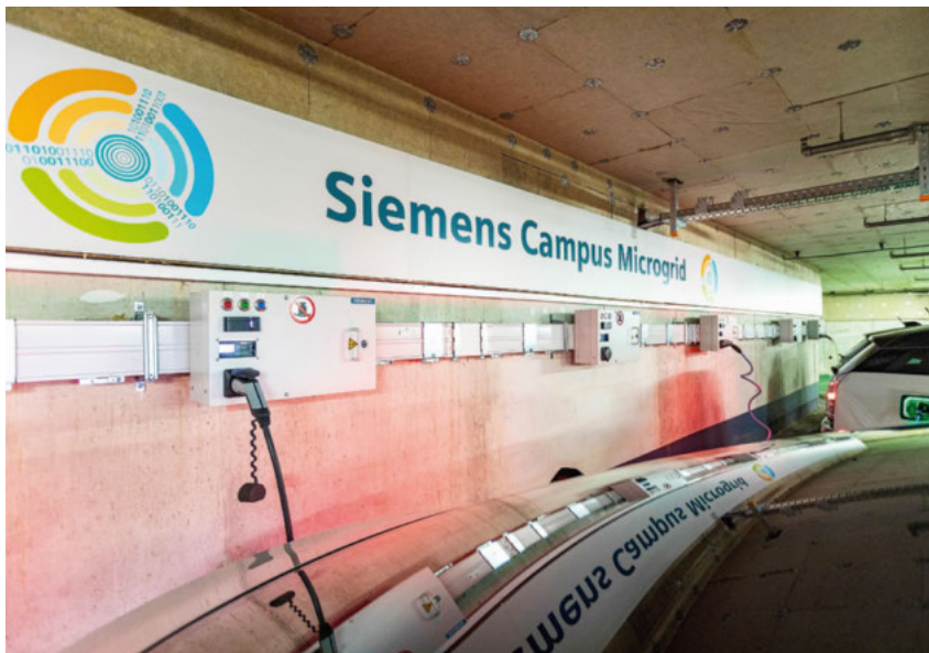
Die Ladestationen am Campus der Siemens City in Wien sind die Testumgebung für die Entwicklung eines Systems, das den Betrieb von Microgrids optimiert.
